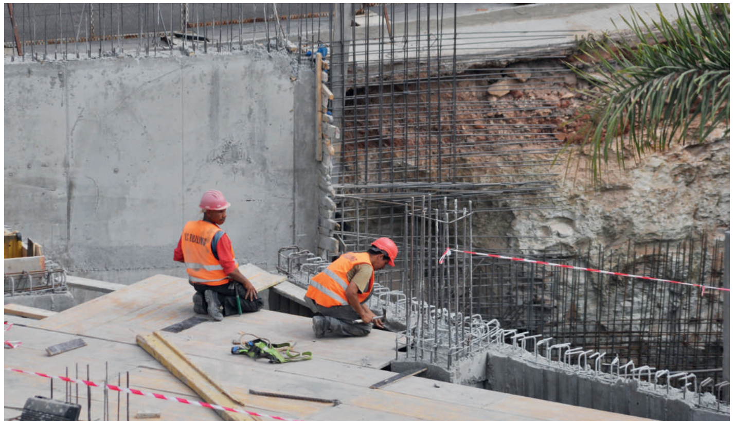
Pour avoir décroché des marchés publics avant la flambée des prix, plusieurs dizaines d'entreprises ne sont plus en mesure de mener les chantiers à terme (Ph. L'Economiste)
