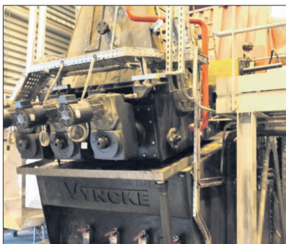
Cette chaudière représente le coeur du dispositif énergétique de l'usine de Renault à Melloussa qui a permis de réduire l'émission de CO2 de près de 135.000 tonnes par an (Ph. L'Economiste)
